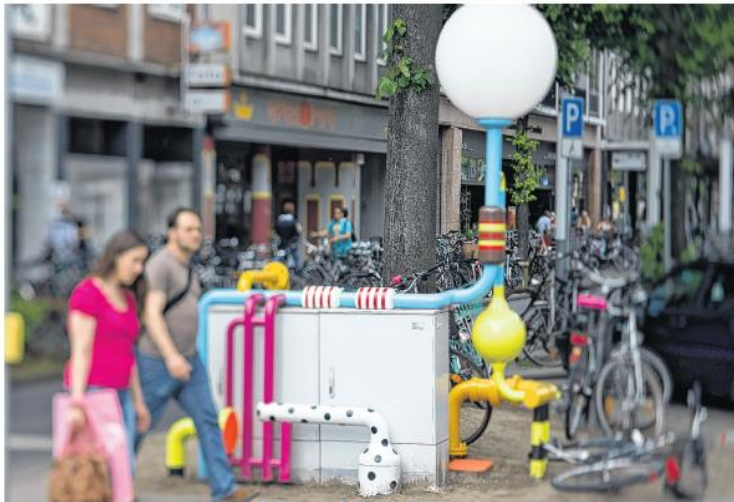
Schaltkästen in Münsters Bahnhofsviertel verschönert Tobias Rehberger mit Installationen wie „Alabama“. Das Exponat ist Teil des Projektes „The Moon in Alabama“. Foto: dpa
